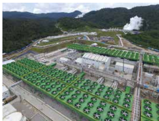
サルーラ地熱発電所第2号機
