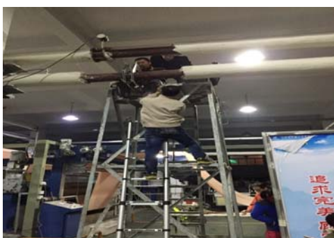
中方设备现场检测
