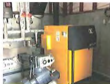
ボイラー本体
