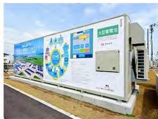
大型蓄電池 (480kWh)
