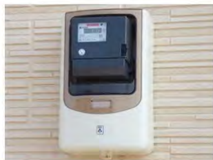
スマートメーター
