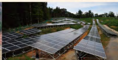
矢吹中丸発電所(739kW)
