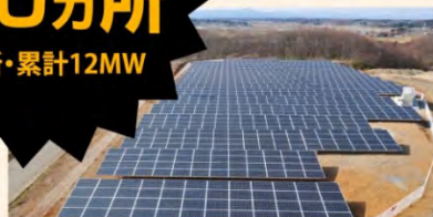
桜岡第三発電所(396kW)
