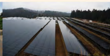
棚倉堂ノ沢発電所(2678kW)
