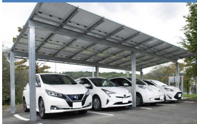
カーポートPV
