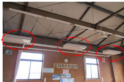
天井吊型空調機
