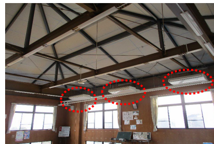
天井吊型空調機
