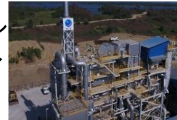
(例) 廃棄物発電施設
