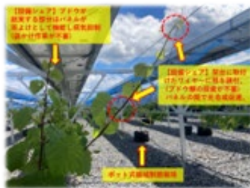
営農型太陽光発電設備
