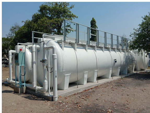
合併処理浄化槽
