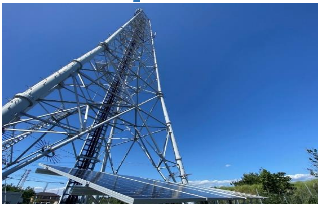
＜サステナブル基地局＞
