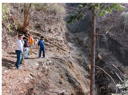
熊野古道小辺路の崩落現場
