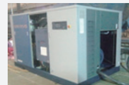
新設された空気圧縮機
