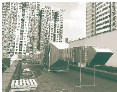
2020年9月、日中友好環境保全センター建物屋上に設置した外食産業等小規模分散型大気汚染源対策モデル施設
