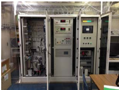
精製空気及び水分発生装置全体
