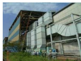
喷涂车间的排气筒
