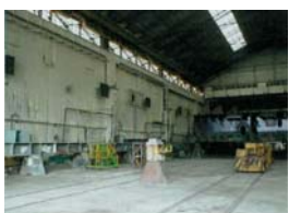
涂装车间的排气扇 (墙壁)
