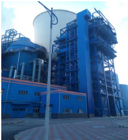
軍糧城発電所のクリーン コール利用
