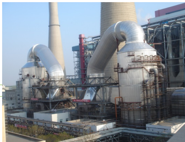
天津国華盤山発電所脱硫施設
