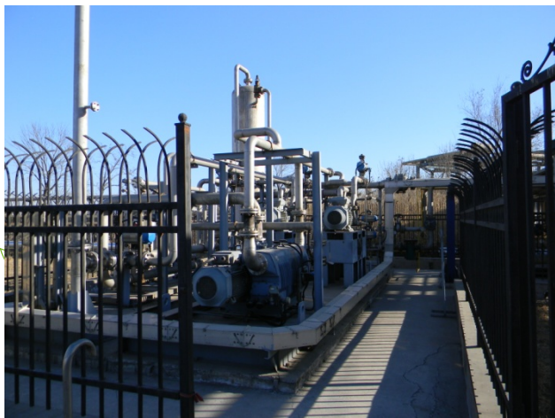
天津石油化学VOC対策装置
