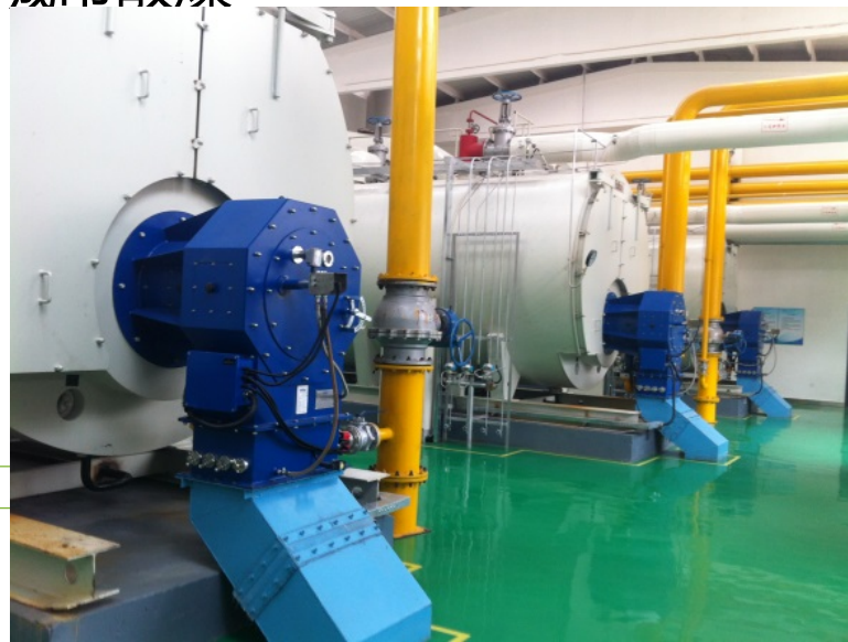
改用天然气锅炉房
