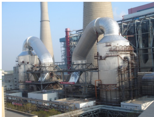
天津国华盘山电厂脱硫设施
