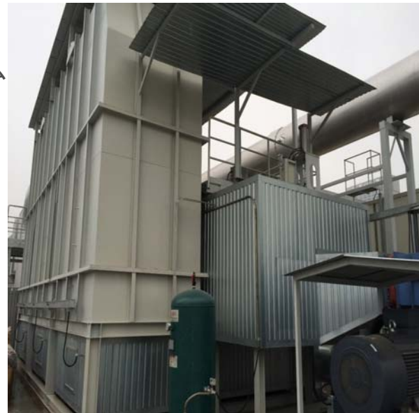
3塔式蓄熱式直燃脱臭システム（RTO）
